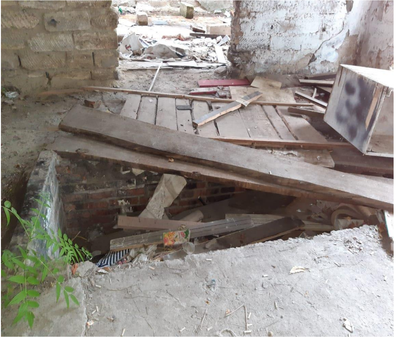
Фото 9. Массовые разрушения покрытия и основания
