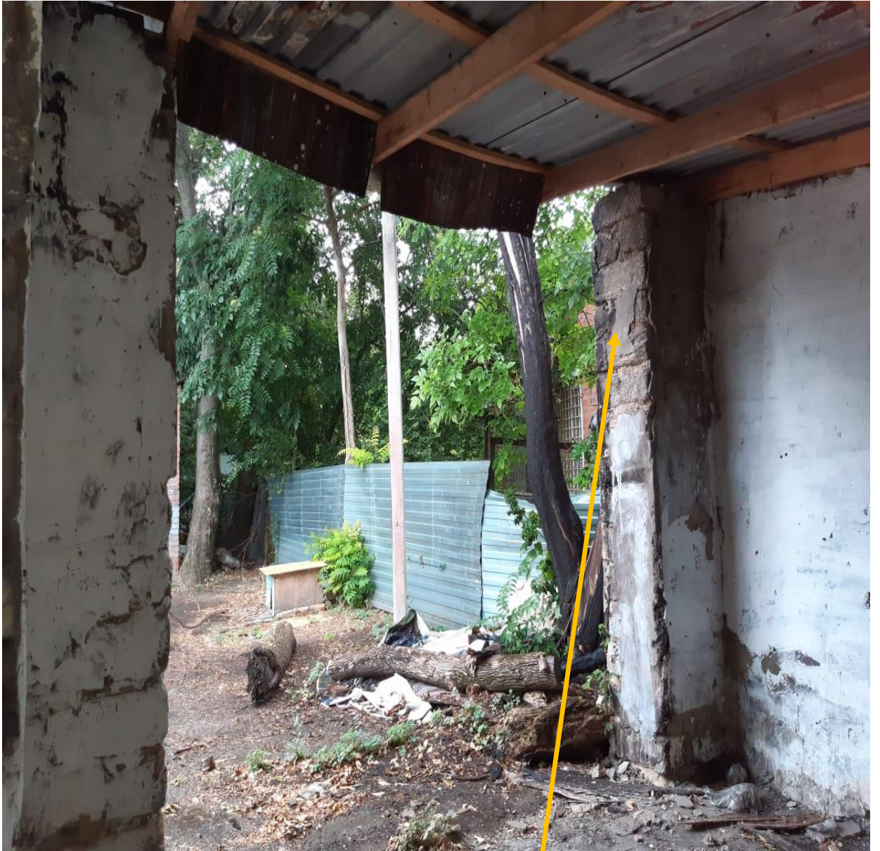
Фото 7. Отсутствие дверных проемов. Следы пожара.
