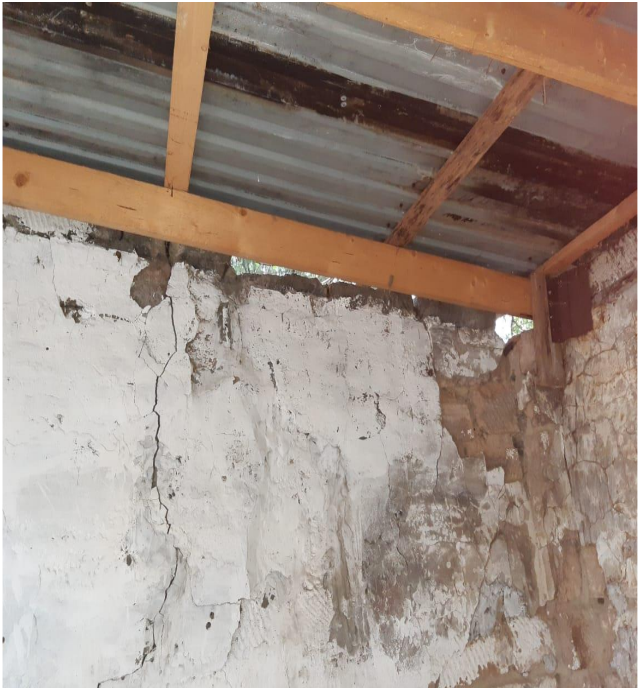
Фото 5. Глубокие трещины и выпадение камней карниза, массовое выветривание швов и камней кладки, отпадение штукатурки
