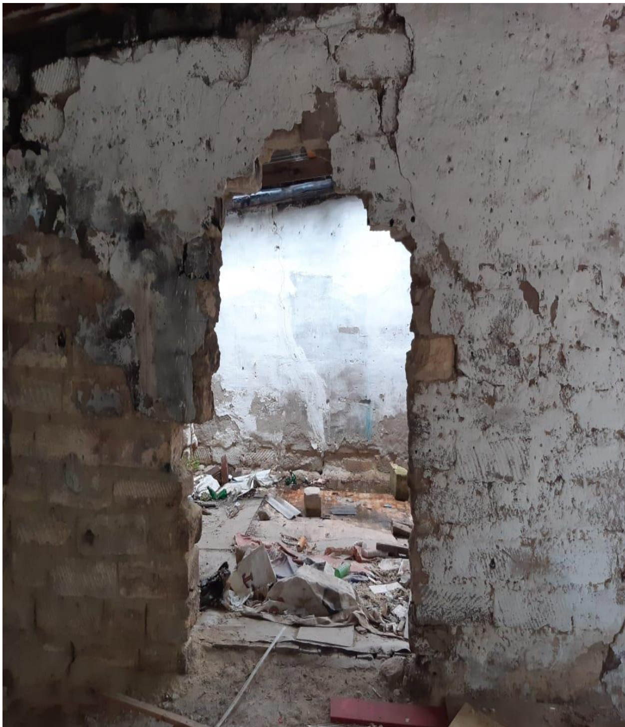
Фото 8. Полное разрушение межкомнатных дверных проемов.
